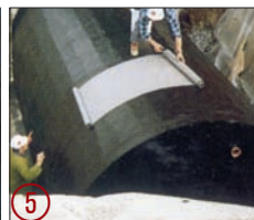
5 Fermeture des joints et installation de la ventilation. Pose du système d'étanchéité recouvert de terre damée.
